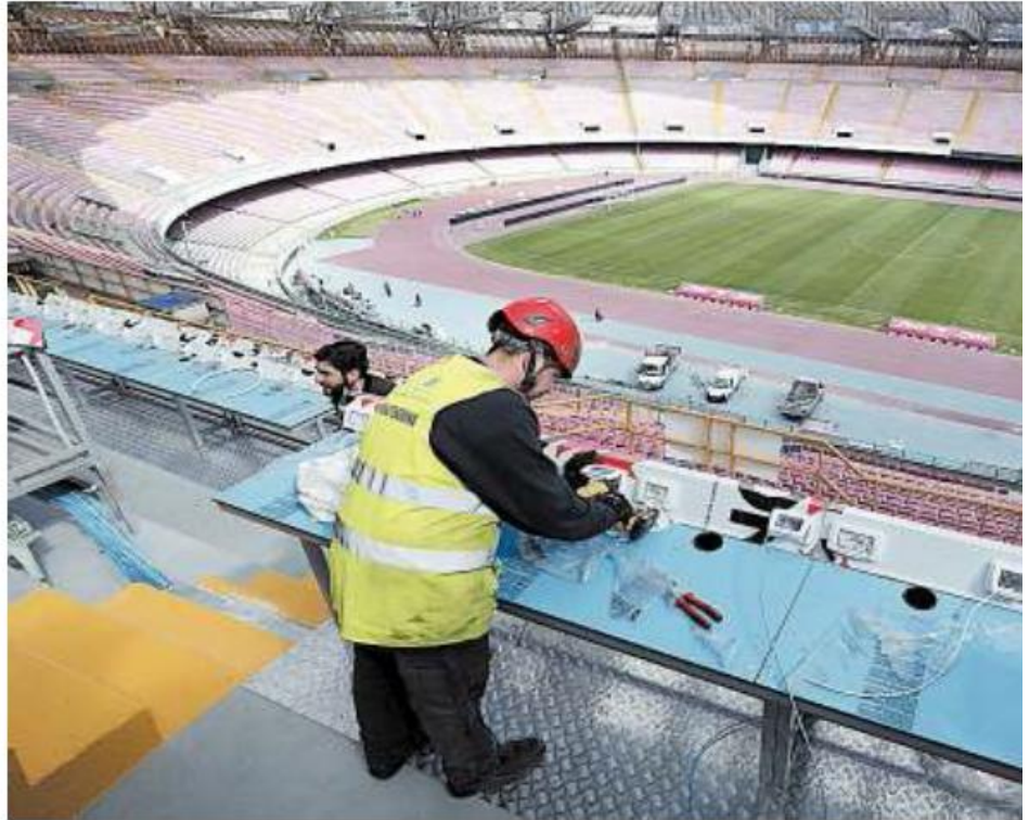
I lavori Bando d'appalto per gli interventi al San Paolo per 5 milioni ma molte aziende
